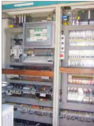
Figura 28.3. Sistema de control que permite hacer la regulación del giro del motor. Fuente: APM terminals.
