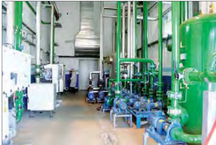
Figura 21.2. Sala de bombas.
