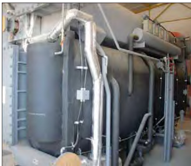
Figura 11.3. Nueva máquina de absorción instalada.
