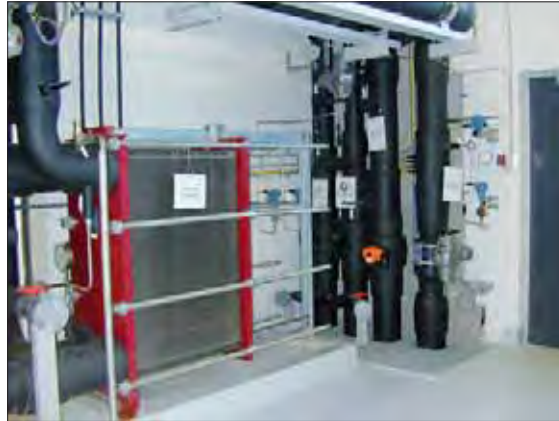
Figura 32.4. Intercambiadores de recepción de energía.
