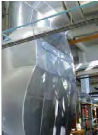
Figura 18.3. Caldera de recuperación. Fuente: Nestlé.
