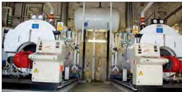
Figura 25.2. Generadores de vapor.
