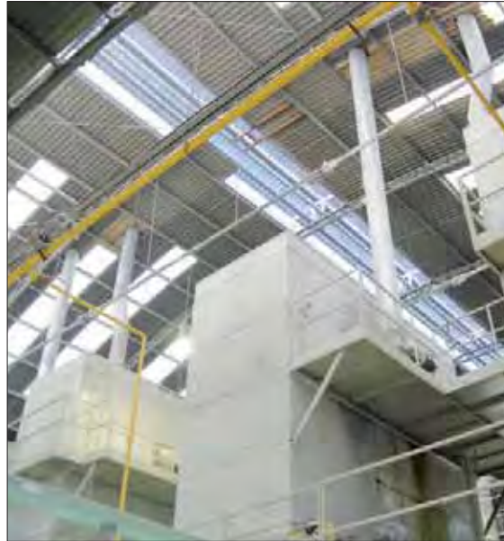
Figura 26.7. Salida de gases del secadero vertical. Fuente: Tau Cerámica.
