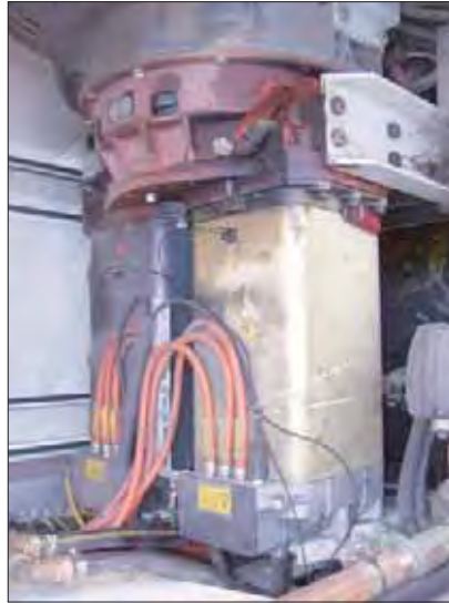
Figura 28.2. Detalle del generador eléctrico del motor. Fuente: APM terminals.
