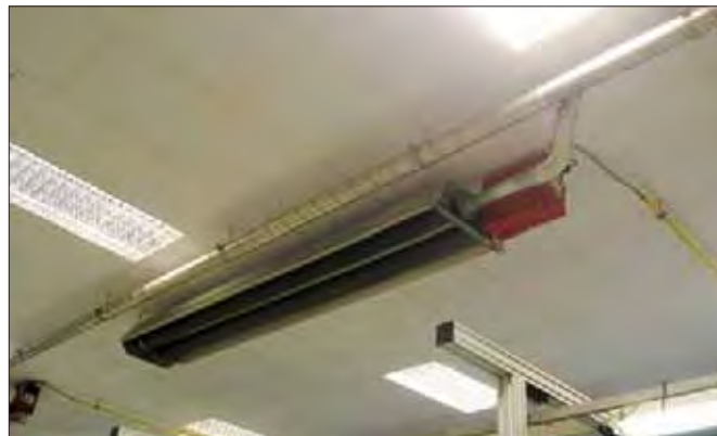
Figura 24.7. Calefacción en puestos de trabajo.
