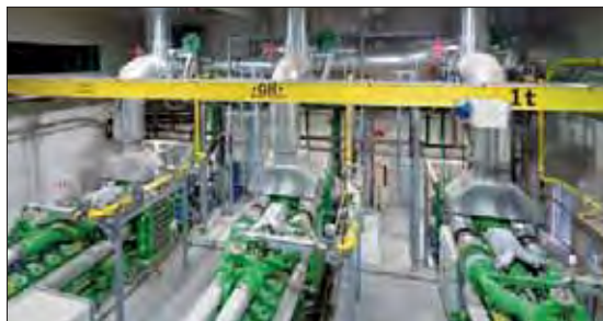
Figura 31.3. Sala de motores. Fuente: Ciudad Agroalimentaria de Tudela.
