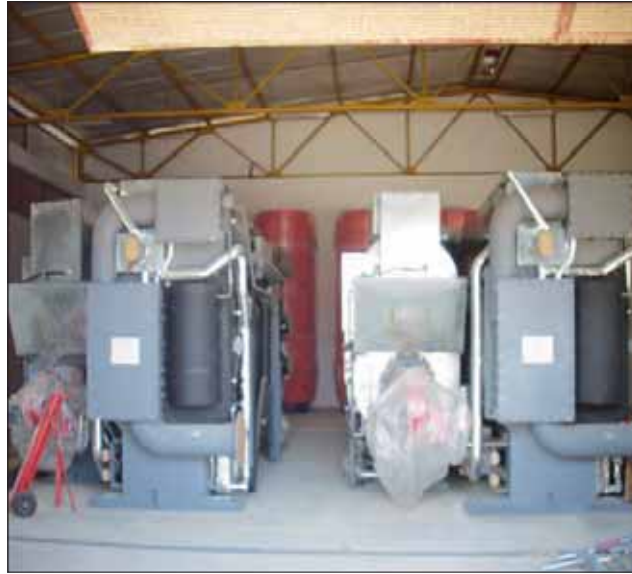
Figura 11.4. Nuevas calderas instaladas.
