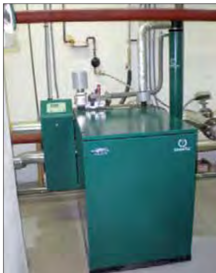
Figura 5.2. Equipo de microgeneración.
