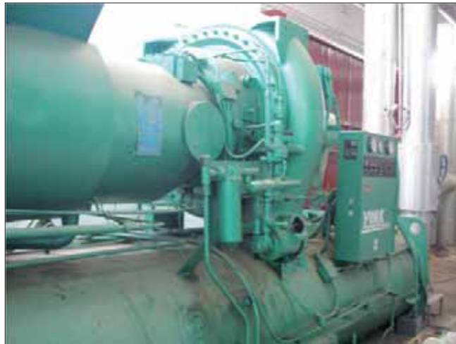
Figura 11.2. Planta enfriadora sustituida.
