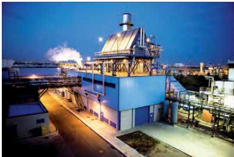
Figura 22.3. Planta de cogeneración.
